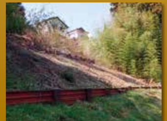
東日本大震災後 法面上方の住宅に被害はない。
