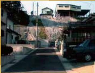
法面崩落箇所
